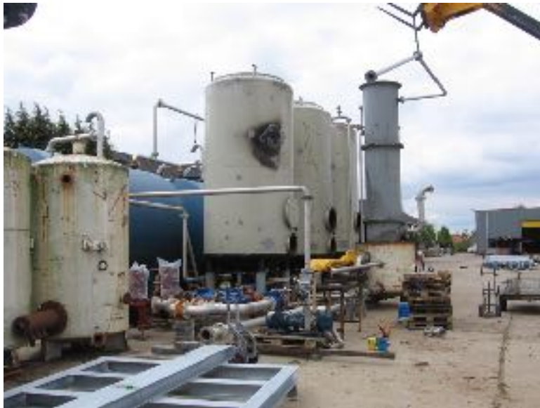
filterinstallatie in opbouw, fa. Rook
