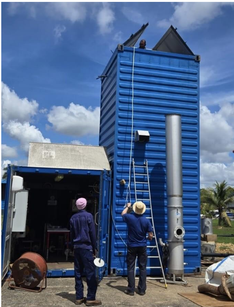
Installatie opgesteld aan de van Hattemweg
